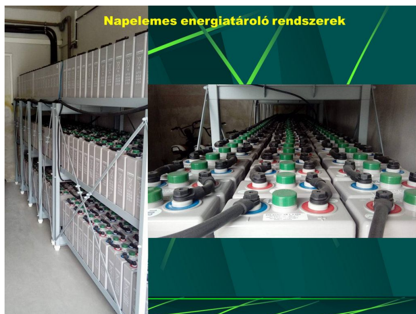
5.ábra: 30 kVA-es UPS akkumulátor telepe
